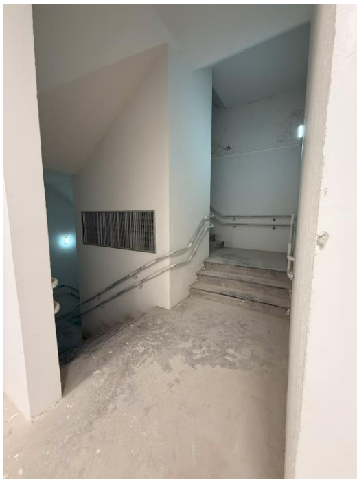
Figura 40: Escada de Incêndio Pressurizada
