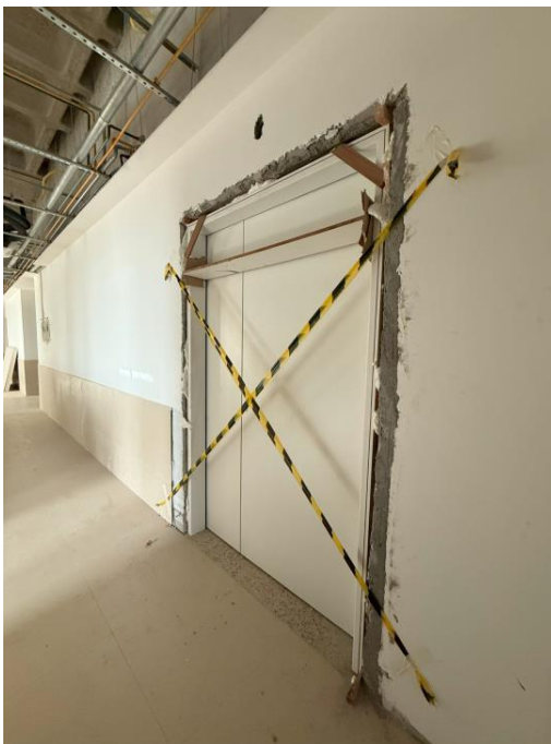
Figura 38: Porta da Tomografia instalada
