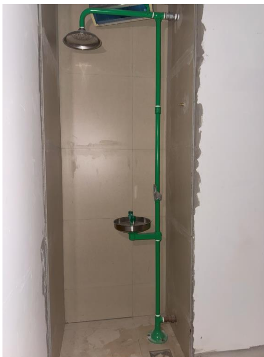
Figura 36: Chuveiro de Emergência da Manipulação Quimioterápicos
