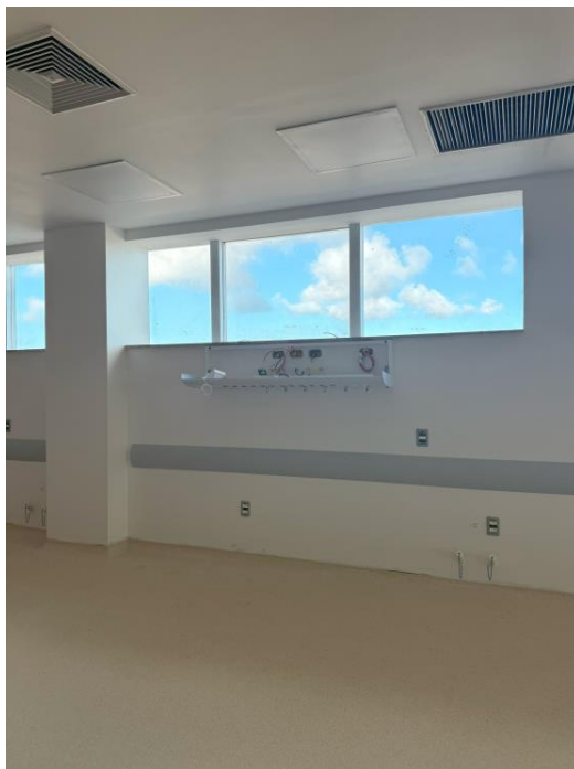
Figura 46: Régua de Gases em instalação
